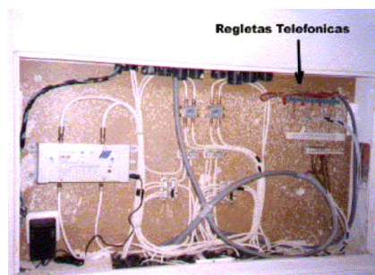
Registro Secundario con todos los servicios instalados
